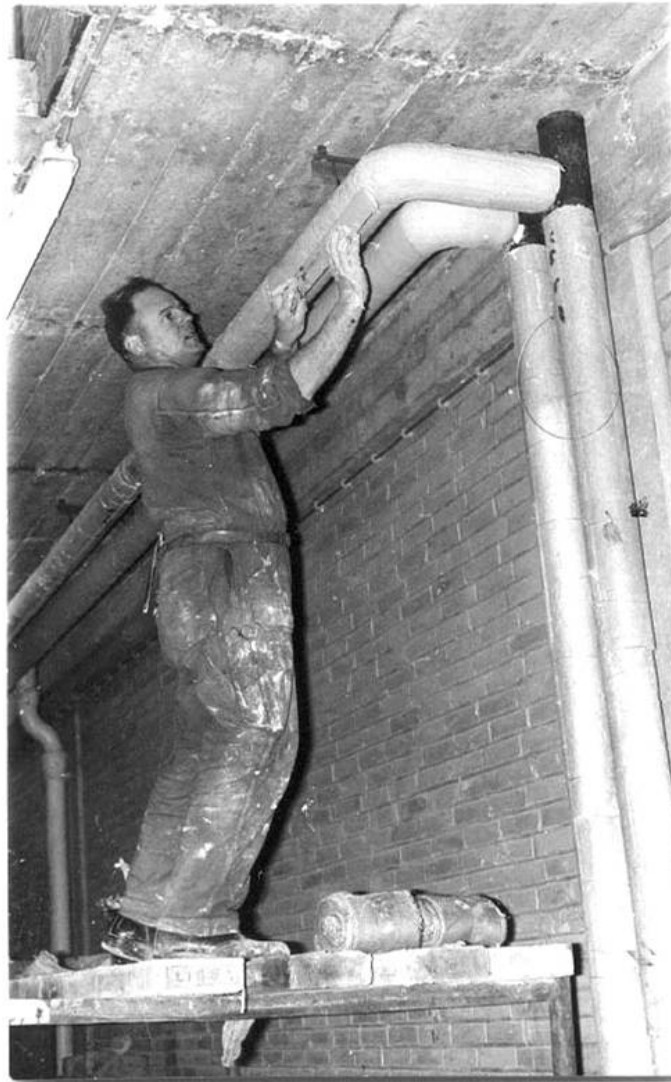
Pijpen met asbestisolatie
